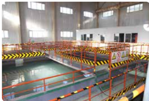
尾矿压滤干排回水系统
