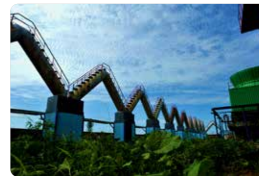
潼关冶炼公司废渣综合回收系统
